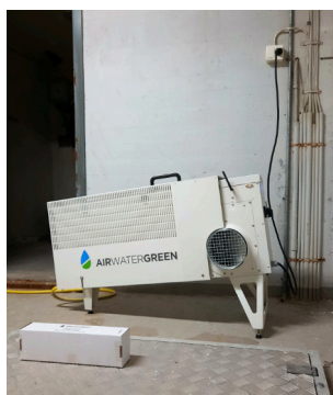
FLEX installerad för test
