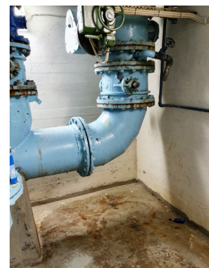
Korrosion på rör
