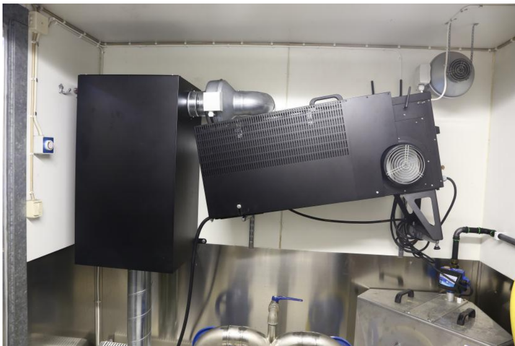
Figur 3: Installationen visar FLEX med ett kolfilter till vänster om varmkondensatorn.
