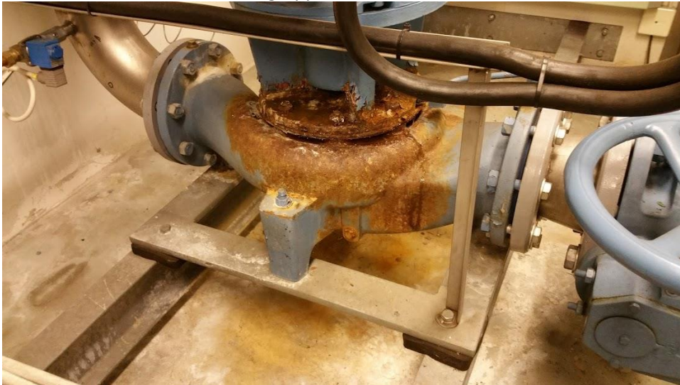
Figur 1: Exempel på ett korrosionsangrepp i en pumpstation
